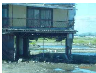
△津波被災現場
