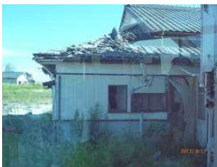
△津波被災現場
